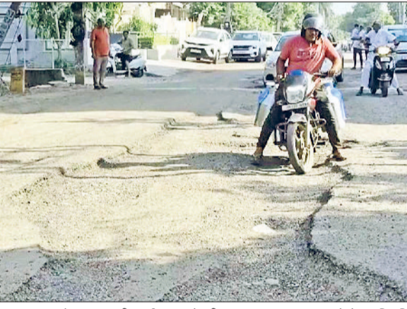
बहादुरगढ़। सेक्टर-6 की जर्जर सड़कों की हालत। फोटो : हरिभूमि
